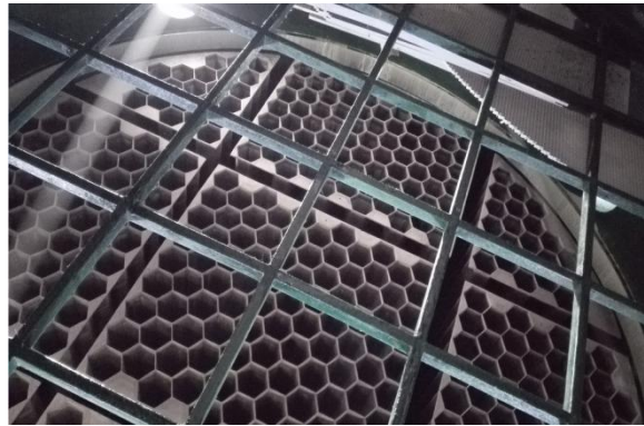
安装在塔内的状况
